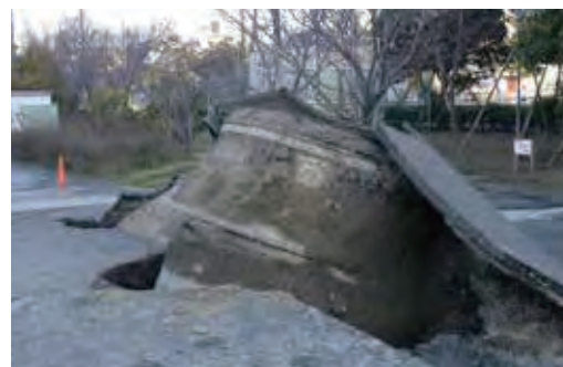
液状化の影響を受けたマンホール(千葉県浦安市) [平成23(2011)年 東日本大震災] (出典: 浦安市「浦安震災アーカイブ」)
